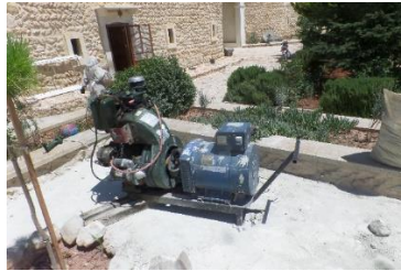
Motor die voor de nodige elektriciteit zorgt
